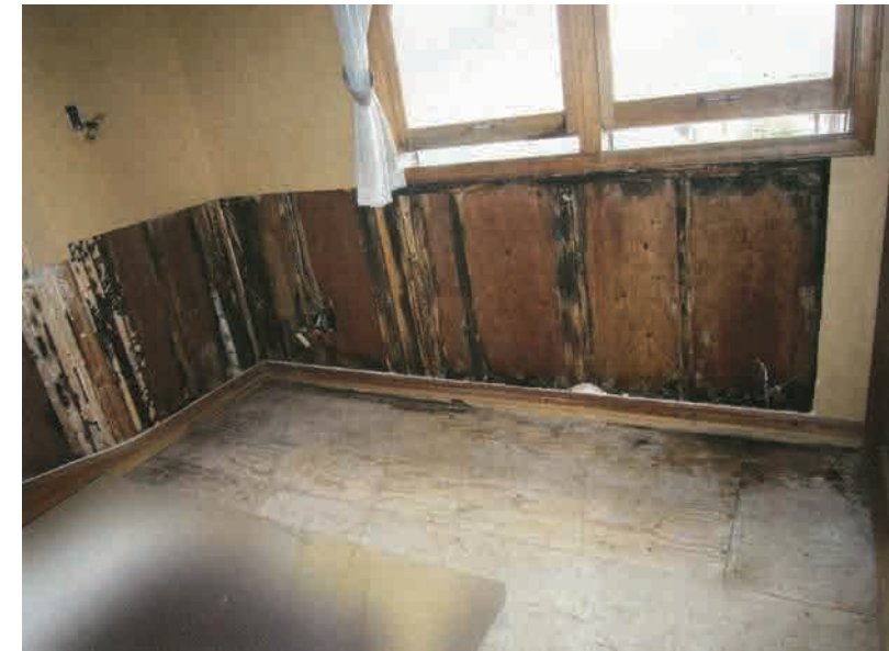
左の写真 築10年、通気層なし 合板の内側と外側が、カビにより著しく腐朽 ⇒ 結露が原因 (日経ホームビルダー 2019. 7)
